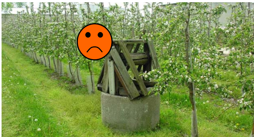
Fig. 73 – Pozzo non adeguatamente protetto (Foto ISK)
