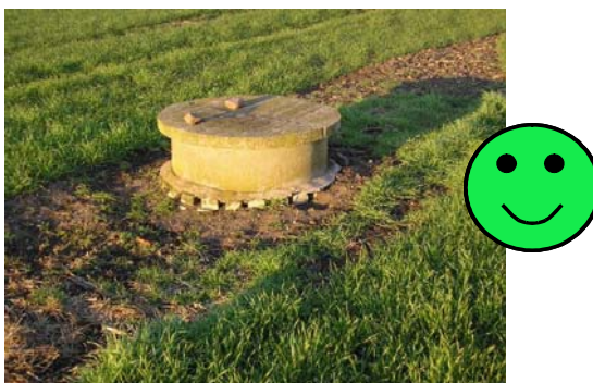
Fig. 32 – Pozzo adeguatamente protetto (foto Harper Adams).
