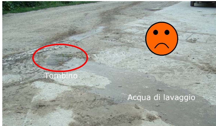
Fig. 103 – Acque di lavaggio immesse direttamente nella rete fognaria
